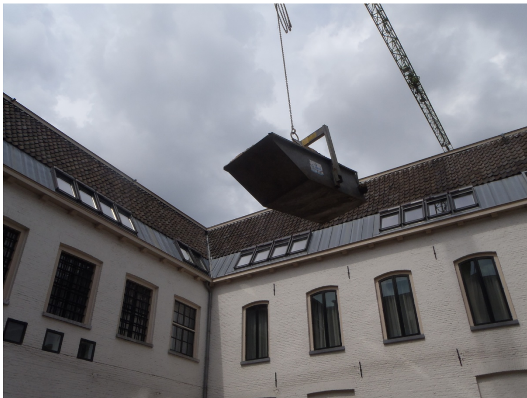
Afb. 8. De tegelbestrating en uitgegraven grond wordt met bakken over het dak afgevoerd.
